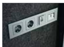
Connexions dans la cabine
